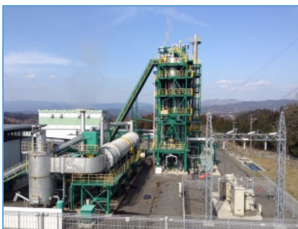
バイオマス（木質）発電
