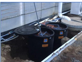
地下水熱源ヒートポンプ
