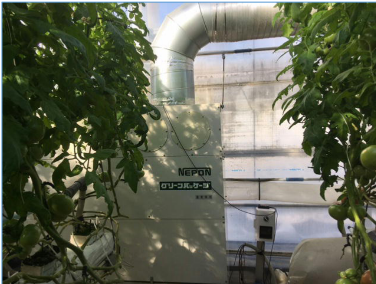
ヒートポンプ室内機
